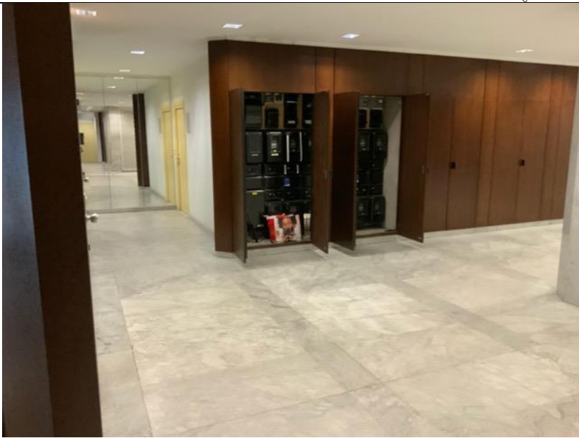
Foto 7 : elektriciteitsvoorziening in wandkasten gelijkvloers
