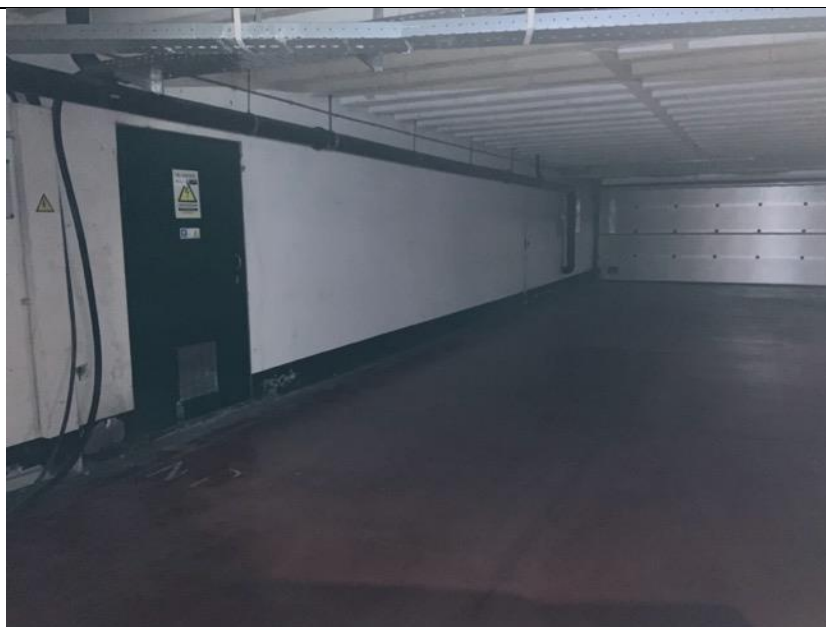
Foto 12 : niet toegankelijke HS-cabine in ondergrondse parking op -1
