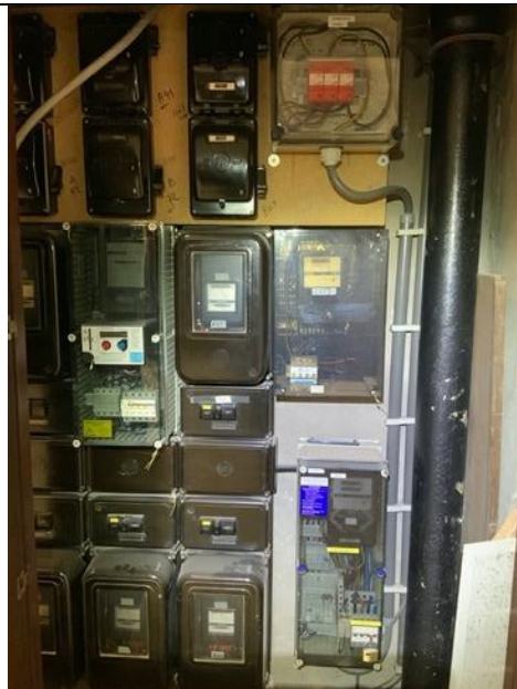
Foto 8 : elektriciteitsvoorziening in wandkasten gelijkvloers
